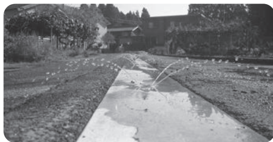
使用中の消雪パイプ
