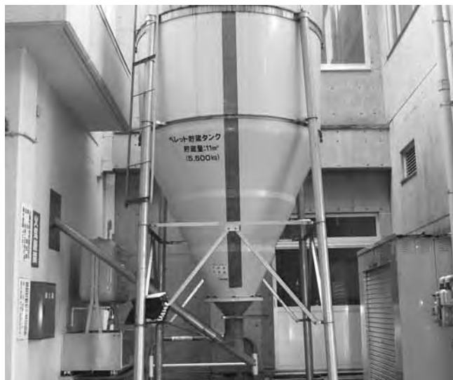
津川小学校暖房設備 ペレットボイラー導入
