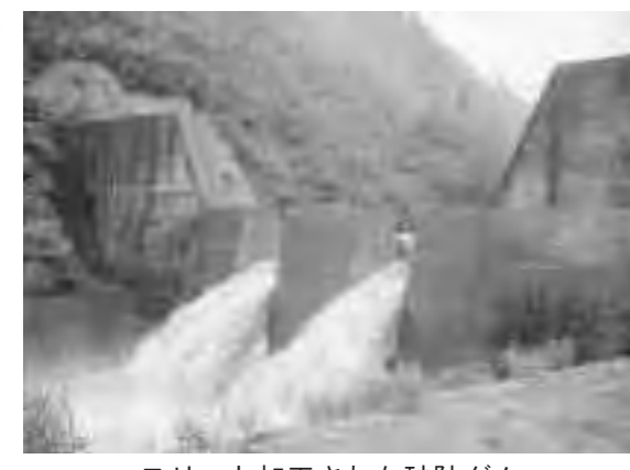
スリット加工された砂防ダム
