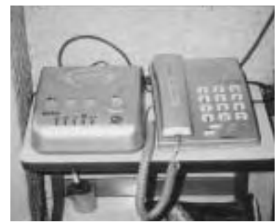
緊急連絡装置
