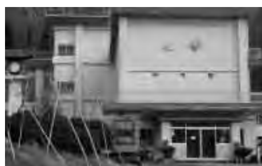
老朽化している三川小・中学校
