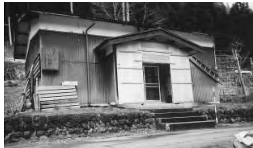
老朽化した観音様施設利用の集会所（上川地域 明谷沢区）
