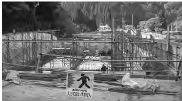
南部地区簡易水道施設（日野川）
