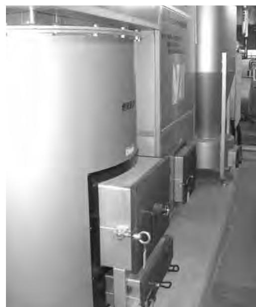
ペレットボイラー（上条小学校）
