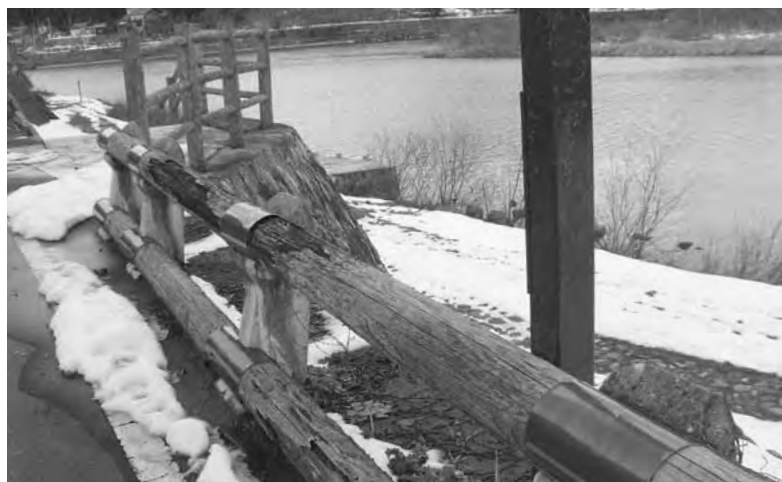
腐食している木さく（河港付近）
