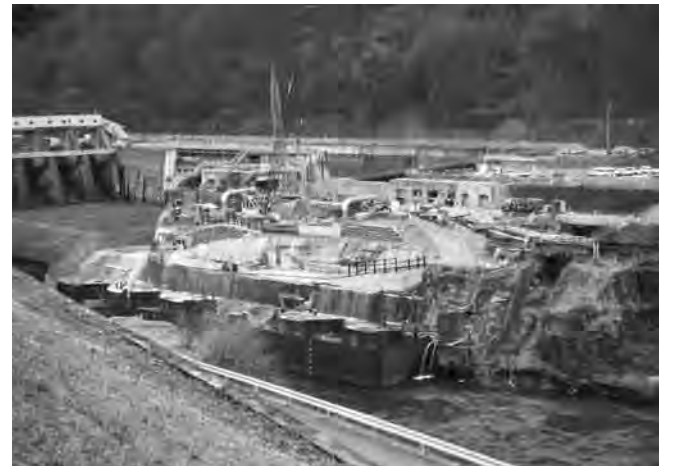
改良すすむ豊実発電所
