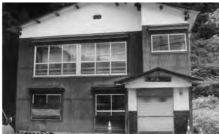
老朽化した非常階段のある集落開発センター(栃堀区)
