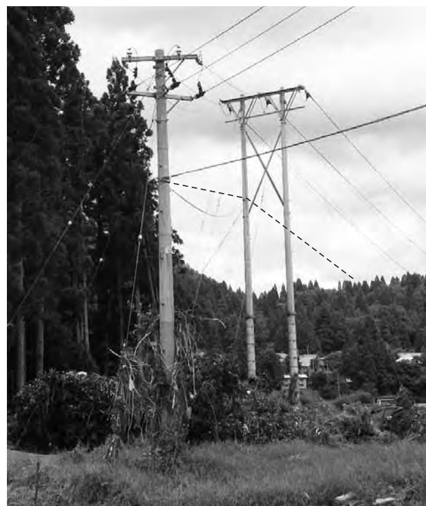
切断(点線力所)された光ケーブル(五十島地内)
