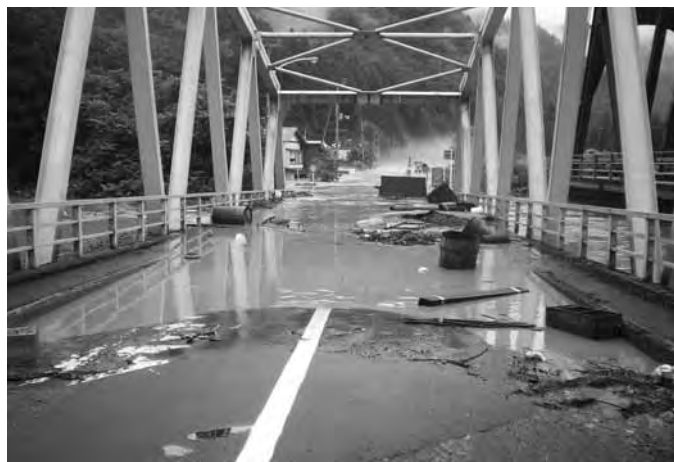
冠水した国道459号線(実川島地内)
