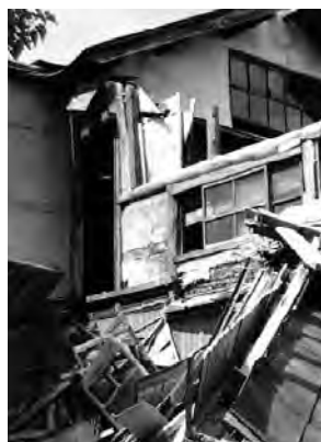
倒壊した家屋
