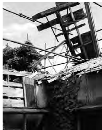
荒れはてた空き家
