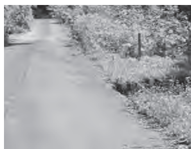
黒岩～大牧線大牧区付近の 陥没箇所（現災害復旧箇所）
