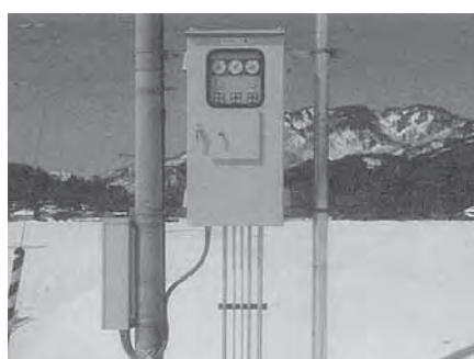
新谷、古岐簡易水道施設
