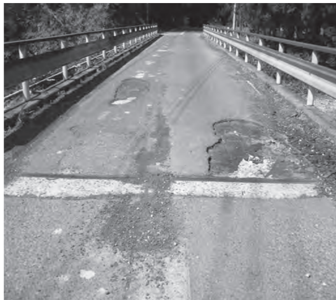
急がれる老朽化した橋の更新
