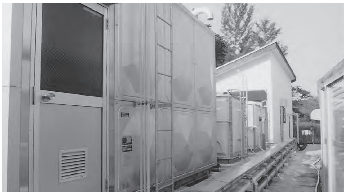
温泉熱源ヒートポンプ施設 (ホテルみかわ専用)
