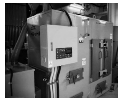
赤崎荘の温泉ボイラー
