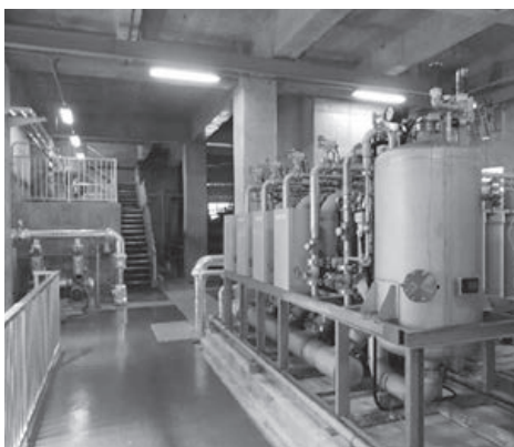
南部浄水場 地域によって設備の違いがある
