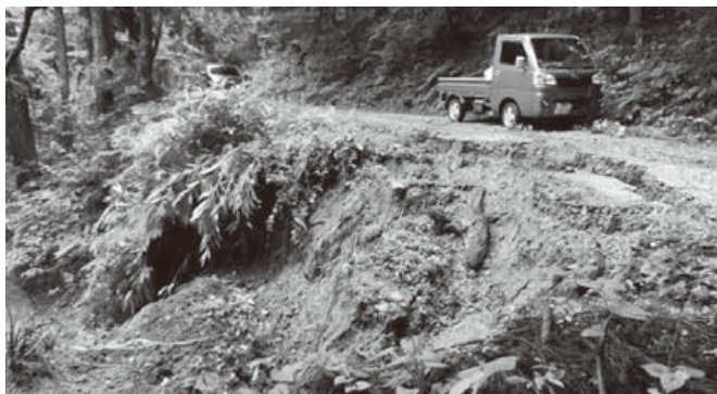
①林道施設災害復旧工事(林道徳瀬線)
