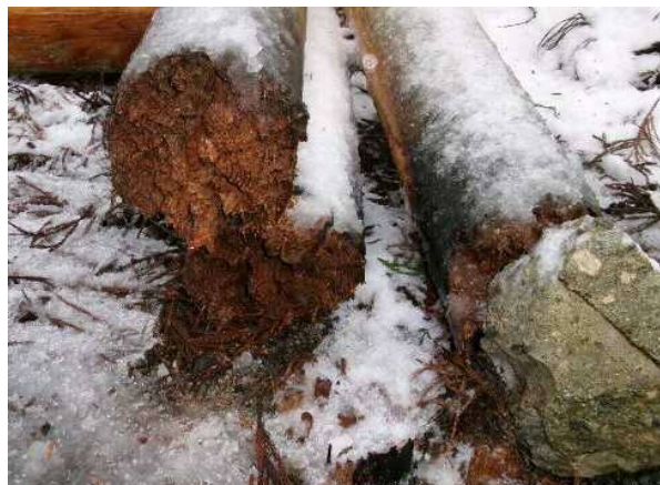
倒壊後（支柱根腐れ状況）
