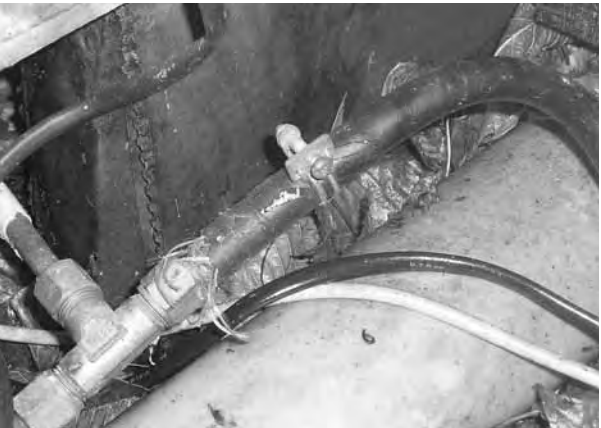
家庭用ボイラーへの接続ゴム配管の亀裂部分
