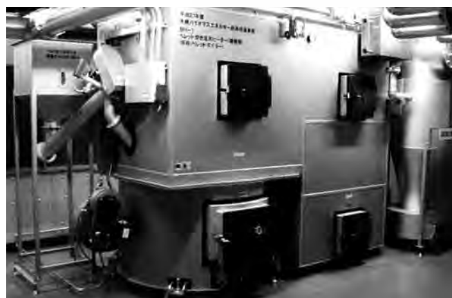
津川小学校に導入されたペレットボイラー
