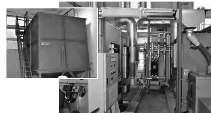
▲清川高原保養センターに整備したペレットタンク(左)とペレットボイラー(右)
