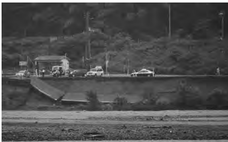
▲路面半分が崩落した大牧区内パーキング付近
