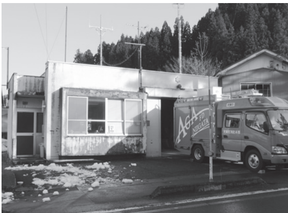
老朽化が著しい消防署上川分遣所
