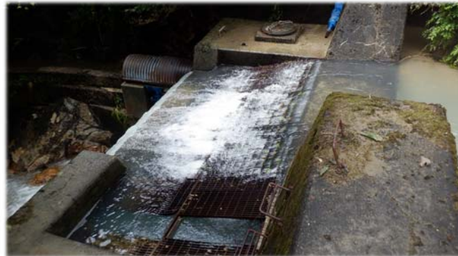
(例)：表流水の取水施設
