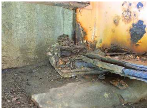
鋼桁の腐食等
